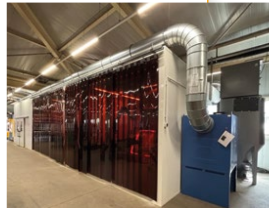
Die neuen Schweiß- und Schleifkabinen im Werk 1.
